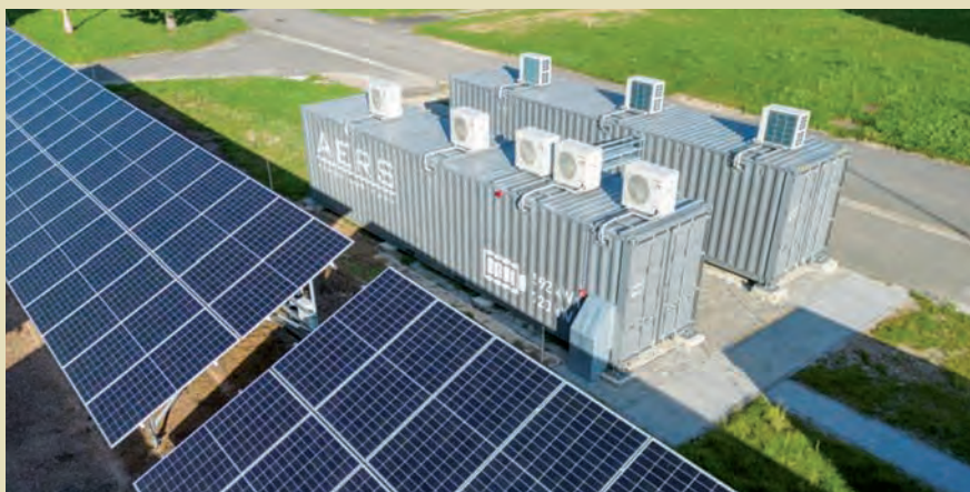
Bateriové úložiště SAS v kontejnerovém provedení
