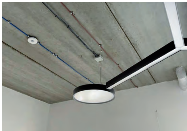
Automatizované osvětlení ve skladovém prostoru v Kralicích na Hané
