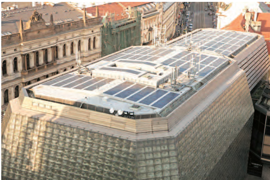
Fotovoltaika od ČEZ ESCO na střeše Národního divadla
